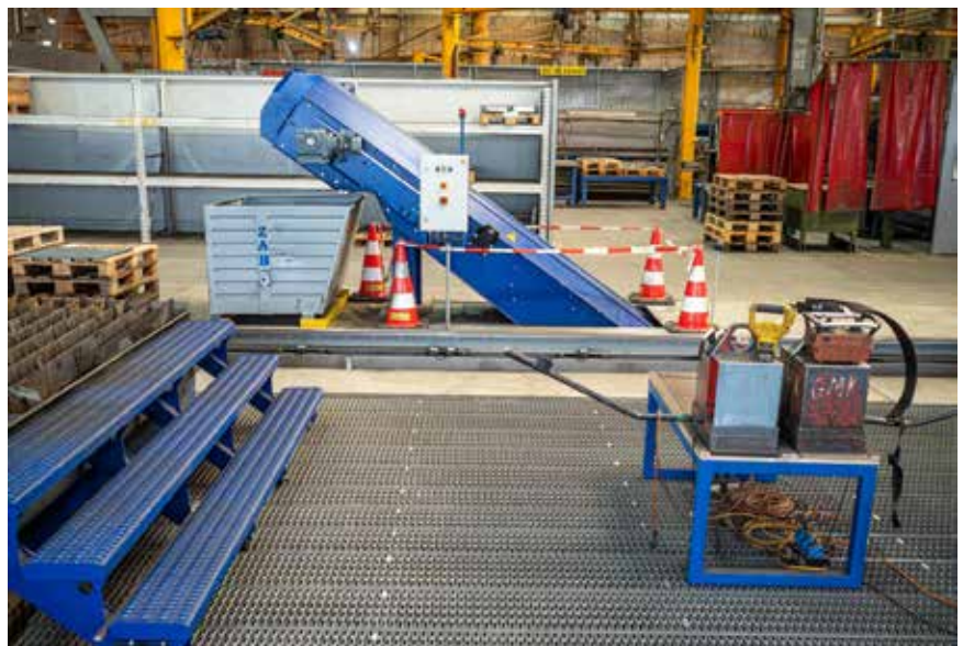
System zum Rückstandsabtransport, bestehend aus zwei ZINtrac Schwingfördertischen, verbunden durch einen Schlackeförderer mit Auswurf
